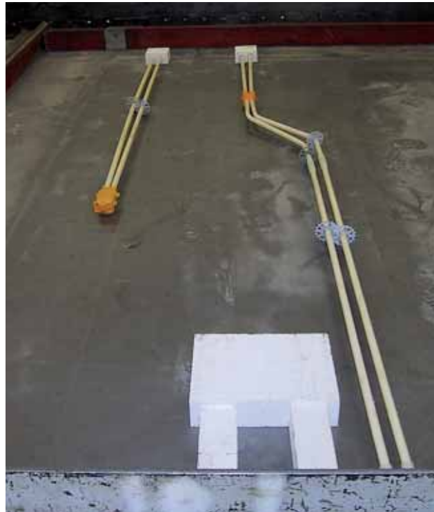
Figur 25. Tilpasning ved VVS-udspæringer. Her er der fremført el til lampen over et spejl i et badeværelse. Rørføringen er tilpasset udspæringerne for brugsvand under håndvasken. Hvis håndvasken skal monteres på væggen, skal det sikres, at der ikke bores ind i et el-rør. Hvis bestemte områder af en væg skal friholdes for el-rør, skal det fremgå af projektet materialet.
