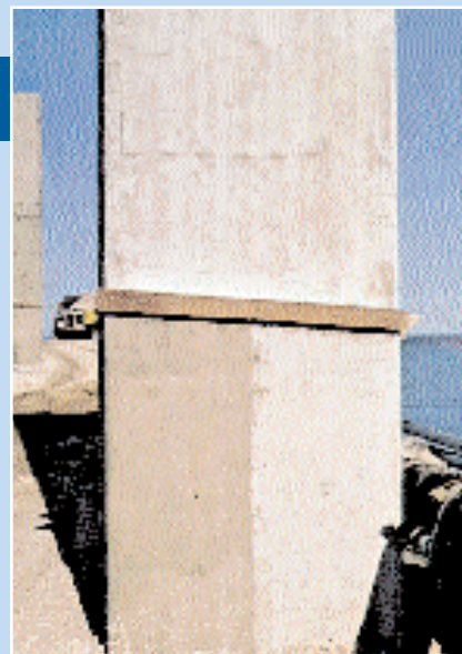
FIG. 3 REGN PÅ NYLIGT AFFORMET BETON MEDFØRER OFTEST KALKUDBLOMSTRING. SØJLEN I FORGRUNDEN FIK KRAFTIG UDBLOMSTRING PÅ SYDSIDEN VED DEN FØRSTE REGN. VINDEN DREV REGNEN MOD DENNE SIDE. NORDSIDEN DERIMOD FIK SVAGERE UDBLOMSTRING, OG DEN KOM FØRST LANGT SENERE. DET SKETE I FORBINDELSE MED REGN OG NORDLIG BLÆST. OVERSKUD AF FORMOLIE OG SOL KAN ØGE UDBLOMSTRINGENS INTENSITET. UNDER PLANKEN ER TO FØRSKILLIGE BESKYTTELSESMIDLER ANVENDT MED FØRSKILLIGT RESULTAT. DESVÆRRE HAVDE DE MODSAT EFFEKT PÅ NORDSIDEN. PILLEN I BAGGRUNDEN ER LIGE AFFORMET. OGSÅ DEN BLEV HVID AF KALKUDBLOMSTRING EFTER DEN FØRSTE REGN.
